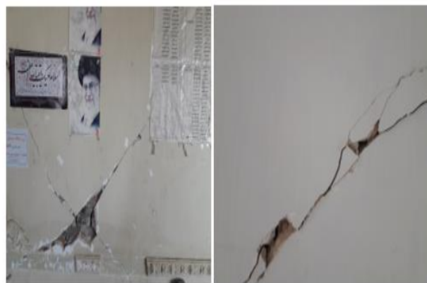
شکل ۷. آسیب‌های وارد شده به ساختمان بعد از زلزله
